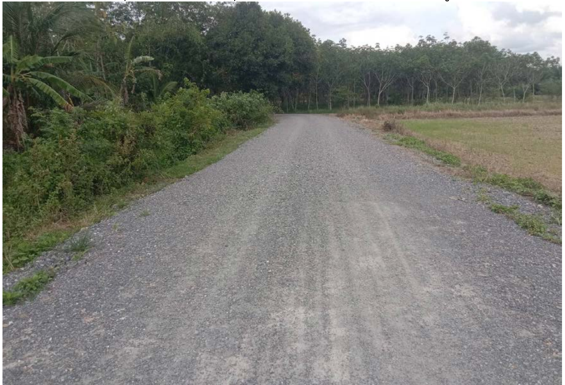
โครงการปรับปรุงถนนสายบ้านสุพรรณิ – เขตตำบลควนพัง หมู่ที่ ๔
